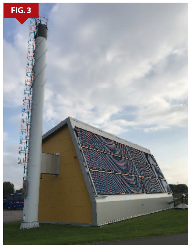
Fig. 3. Piccolo impianto di teleriscaldamento solare in Svezia
